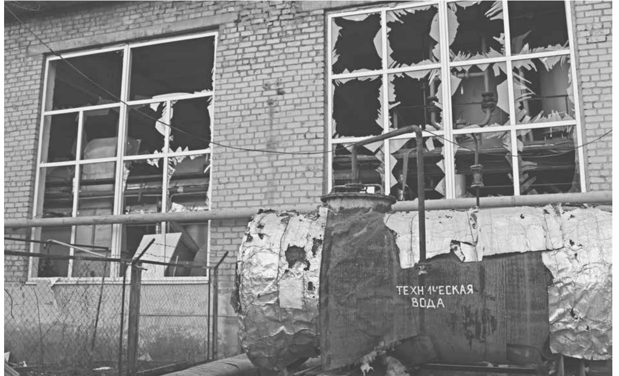
Поврежденная обстрелом котельная в Ворошиловском районе Донецка
