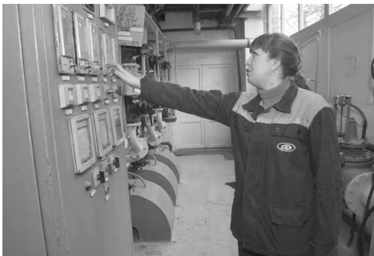
Специалист контролирует работу котельной
